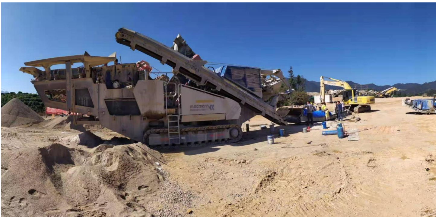
使用现场 use site
